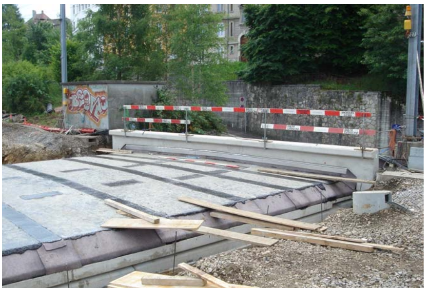
Etanchéité du PI
