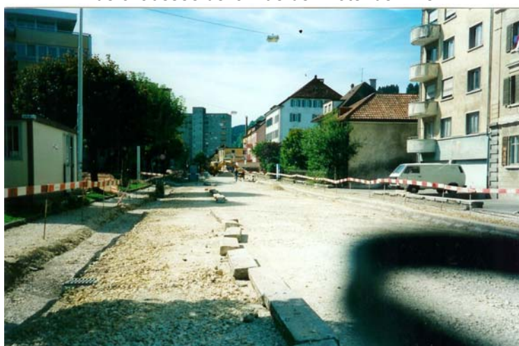
Réalisation de la nouvelle superstructure de chaussée de la Rue de l'Hôtel-de-Ville
